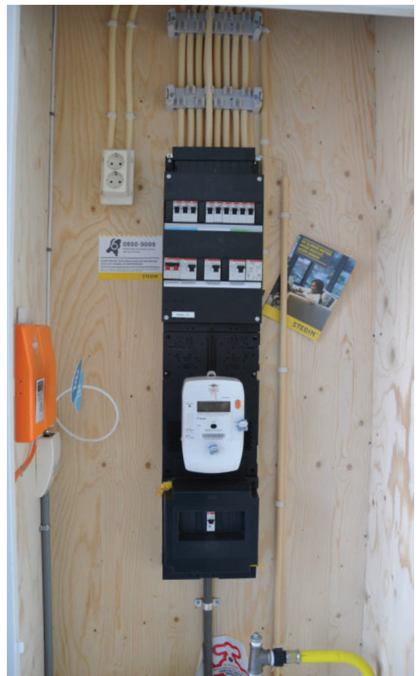
Foto 1. Voor veel mensen is de meterkast nog steeds een hok met een slimme meter en wat stoppen. In werkelijkheid is het steeds meer de energierotonde van de woning.
