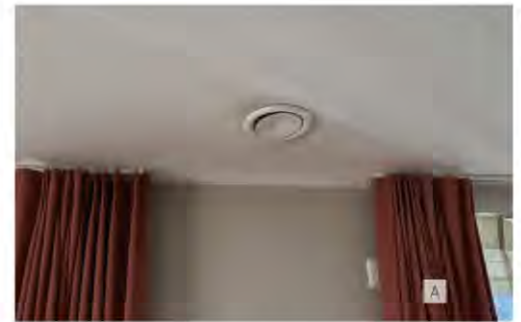
Slecht ingeregelde roosters beperken ventilatiedebiet.
