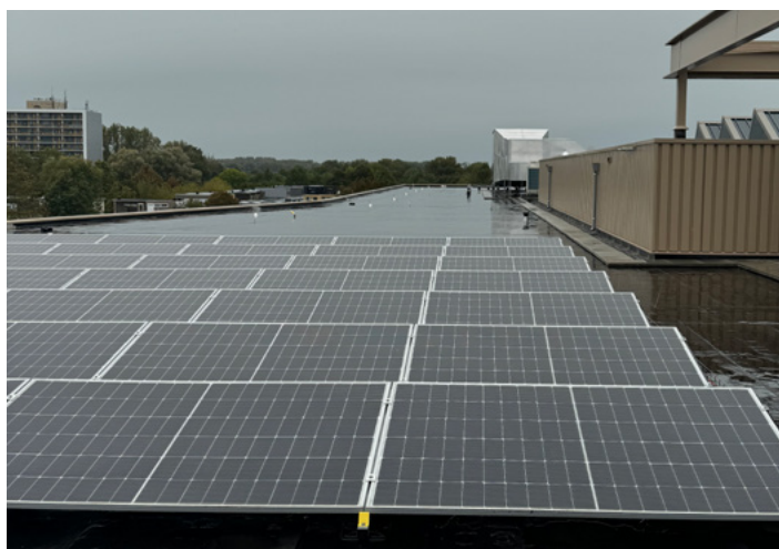
Foto 2: Op het dak zijn 117 zonnepanelen neergelegd. Meer pv-panelen zijn mogelijk als er een regeling wordt toegevoegd om het pv-vermogen af te kunnen schakelen als er meer energie wordt opgewekt dan er in het gebouw wordt verbruikt.
