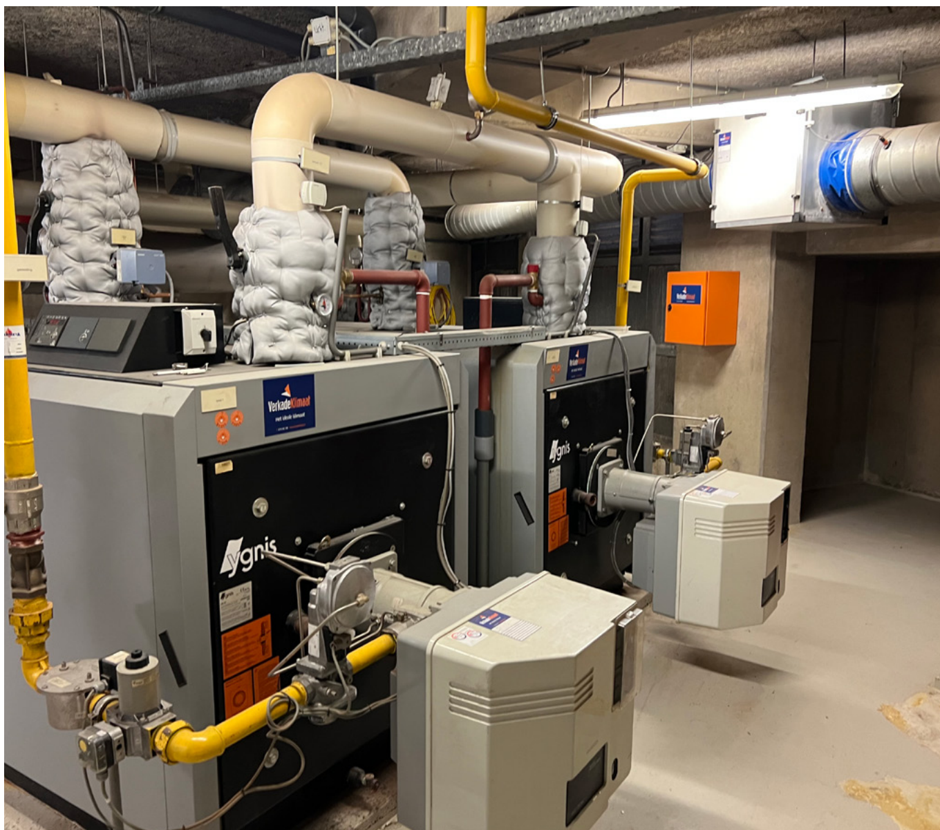
Foto 6: De nieuwe warmtepompen staan in de techniekruimte in het souterrain van het zwembad, die gelukkig groot genoeg is, want ook de oude installatie (zie foto) staat er op dit moment nog in. De oude gasketels zijn nog beschikbaar als achtervang, maar het doel is om die uit te faseren als de nieuwe installatie helemaal goed functioneert. Foto: Van Dorp.
