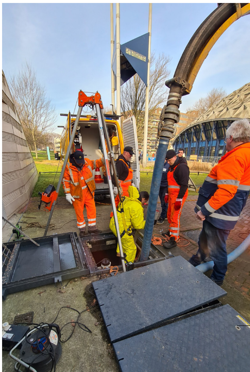
Foto 2: Naast het zwembad zit een rioolgemaal, waar twee grote rioolsystemen samenkomen. Die bron is met een warmtewisselaar gemakkelijk te benutten. Foto: Van Dorp.
