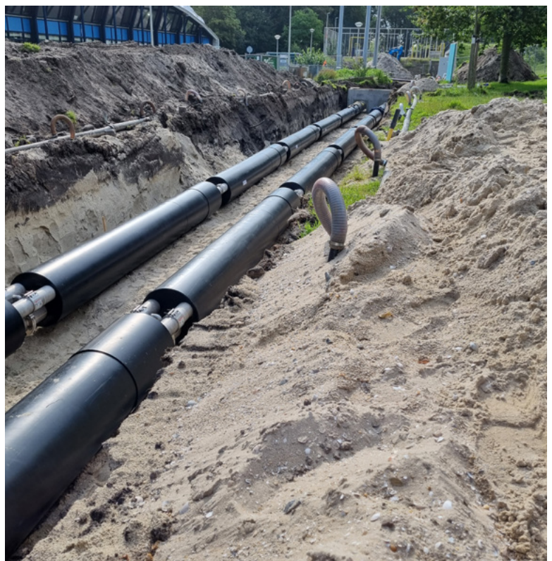
Foto 3 en 4: Het water gaat voordat het naar de rioolwaterzuivering gaat door een bypass in het gazon voor het zwembad. Dat is een dubbelwandig systeem. Door de binnenbuis loopt het rioolwater en door de buitenbuis kouder water in de tegenovergestelde richting. Op deze manier vindt de warmteoverdracht plaats. Foto: Van Dorp.
