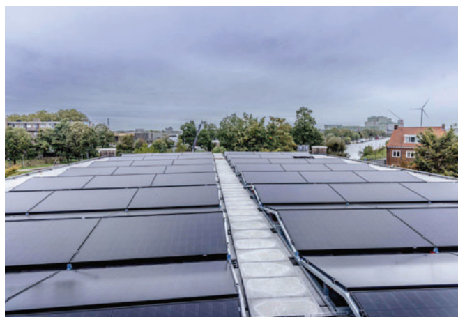
Foto 2: Het dak van het pand is volledig voorzien van 148 zonnepanelen.
