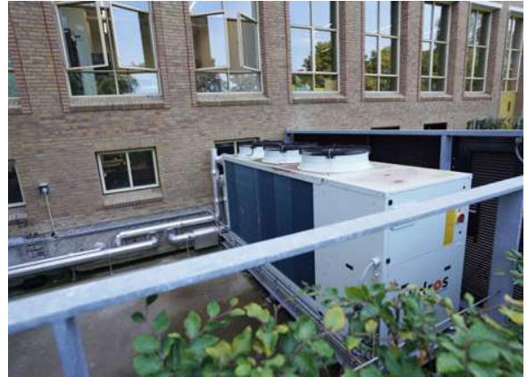
Foto 4: Voor het monumentale deel staan de lucht/water warmtepompen in een soort inham op het maaiveld. Boven de warmtepompen zijn klaslokalen. Daarom zijn er zeer laag geluid warmtepompen geplaatst met grotere ventilatoren, waardoor ze een lager en minder hoorbaar geluid maken.
