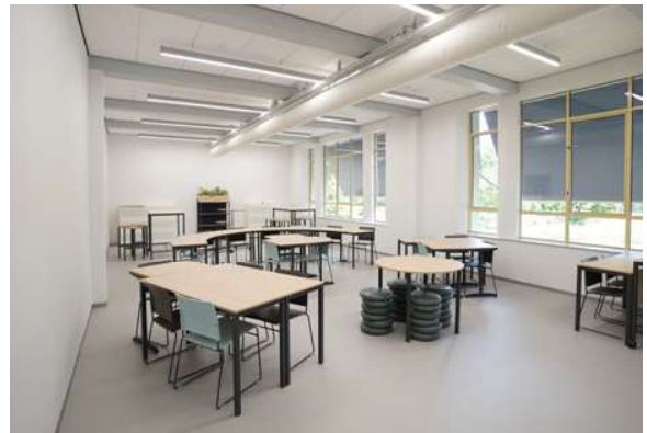
Foto 5: In de oudbouw zijn geen verlaagde plafonds, dat betekent dat alle installaties in het zicht zitten en er dus netjes uit moeten zien. Daarvoor is een geïntegreerde oplossing toegepast van kabelgoot en luchtverdeelslang.
