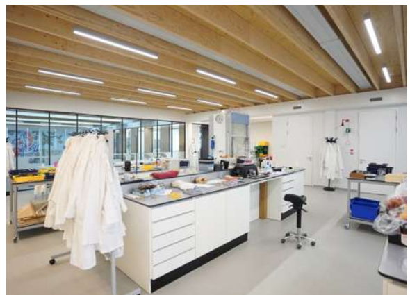
Foto 6: In de nieuwbouw is de overstrom van ventilatielucht geïntegreerd in een plafondplint, waarin ook een brandscheiding aanwezig is.
