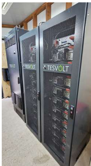
Foto 4: Ruimte waar de batterijen van Tesvolt staan opgeslagen.
