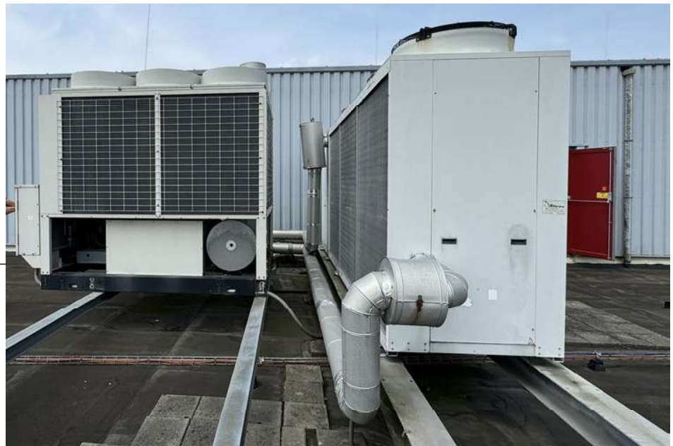
Foto 1: In een kleiner kantoorgebouw (circa 3.500 m 2 BVO) is de oude luchtbehandeling vervangen door luchtbehandeling, die wel voorzien is van hoogwaardige warmteterugwinning, en temperatuurtrajecten die geschikt zijn voor WKO en warmtepompen.
