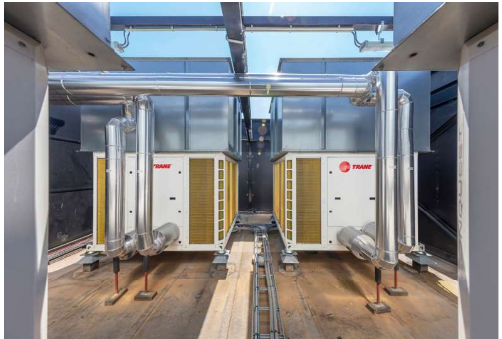
Foto 6: Op het dak van de nieuwbouw zijn 2 warmtepompen in buiten opstelling geplaatst, met een akoestische wand en aan de buitenzijde voorzien van PV-panelen.
