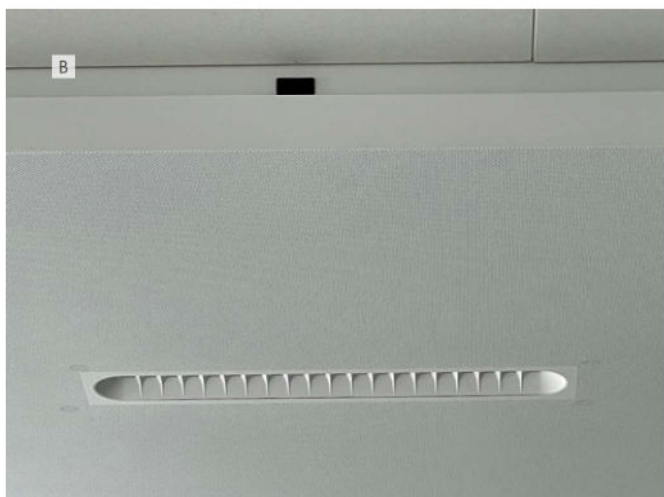
Foto 4a + foto 4b: De verlichting, ook een enorme bron van energiegebruik, is uitgevoerd met een nieuw type led-armatuur. Deze heeft een hogere lichtopbrengst bij een laag energieverbruik van minder dan 6 W/m 2 .
