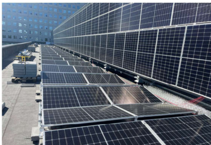
Foto 8: Om zoveel mogelijk duurzame energie op te wekken is ook de techniekstrook vol gelegd met zonnepanelen, zelfs met panelen aan de zijkant van de techniekstrook.
