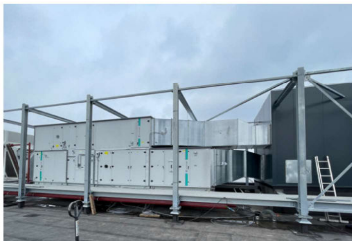
Foto 7: Op het dak van de nieuwbouw is een techniekstrook gemaakt, waarin de liftuitloop, 3 grote luchtbehandelingskasten, de dry-cooler en aansluitingen naar de schachten zijn gepositioneerd.
