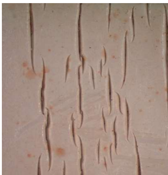
Figuren 6a en 6b: Scheurvorming in PP-buis na 8 jaar gebruik bij 55°C.
