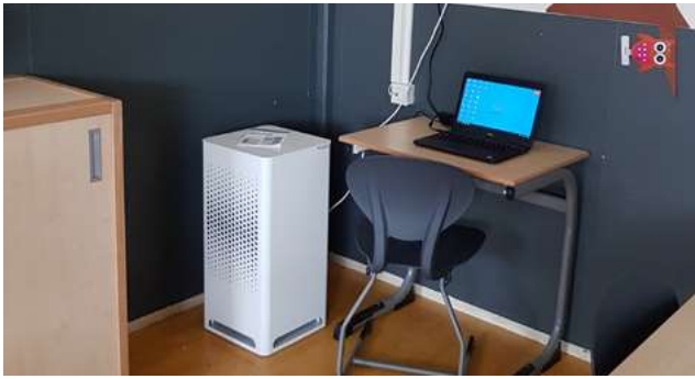
Foto 2: Opstelling van het mobiele HEPA-filter.
