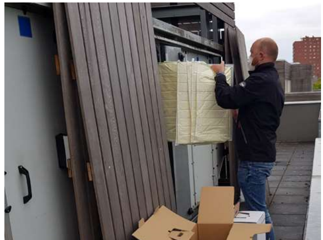
Foto 1: Het betere toevoerfilter (ePM1 85%) wordt door Camfil in de luchtbehandelingskast geplaatst.
