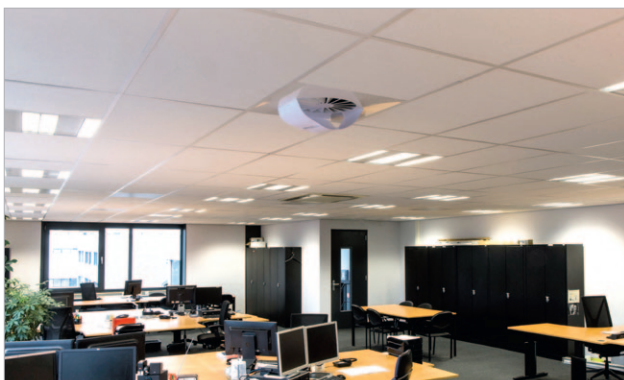
Bestaande situatie: Kantoor met tochtklachten
