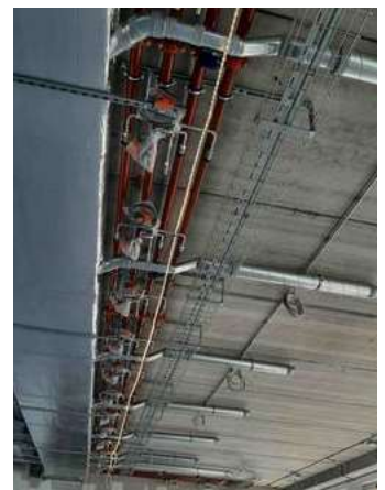
Foto 2,3,4: De kantoren zijn nu uitgerust met klimaatplafonds, waardoor koeling en verwarming mogelijk is. De klimaatplafonds zijn over de hele oppervlakte van het plafond gemonteerd tussen bandrasters van 1,80 meter.
