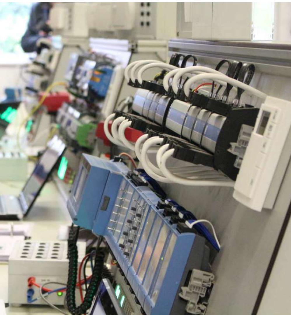
Foto 1: Doel van de implementatie van GACS-regelgeving door de EU is met name het verbeteren van energieprestaties van gebouwen. Foto: ROVC.
