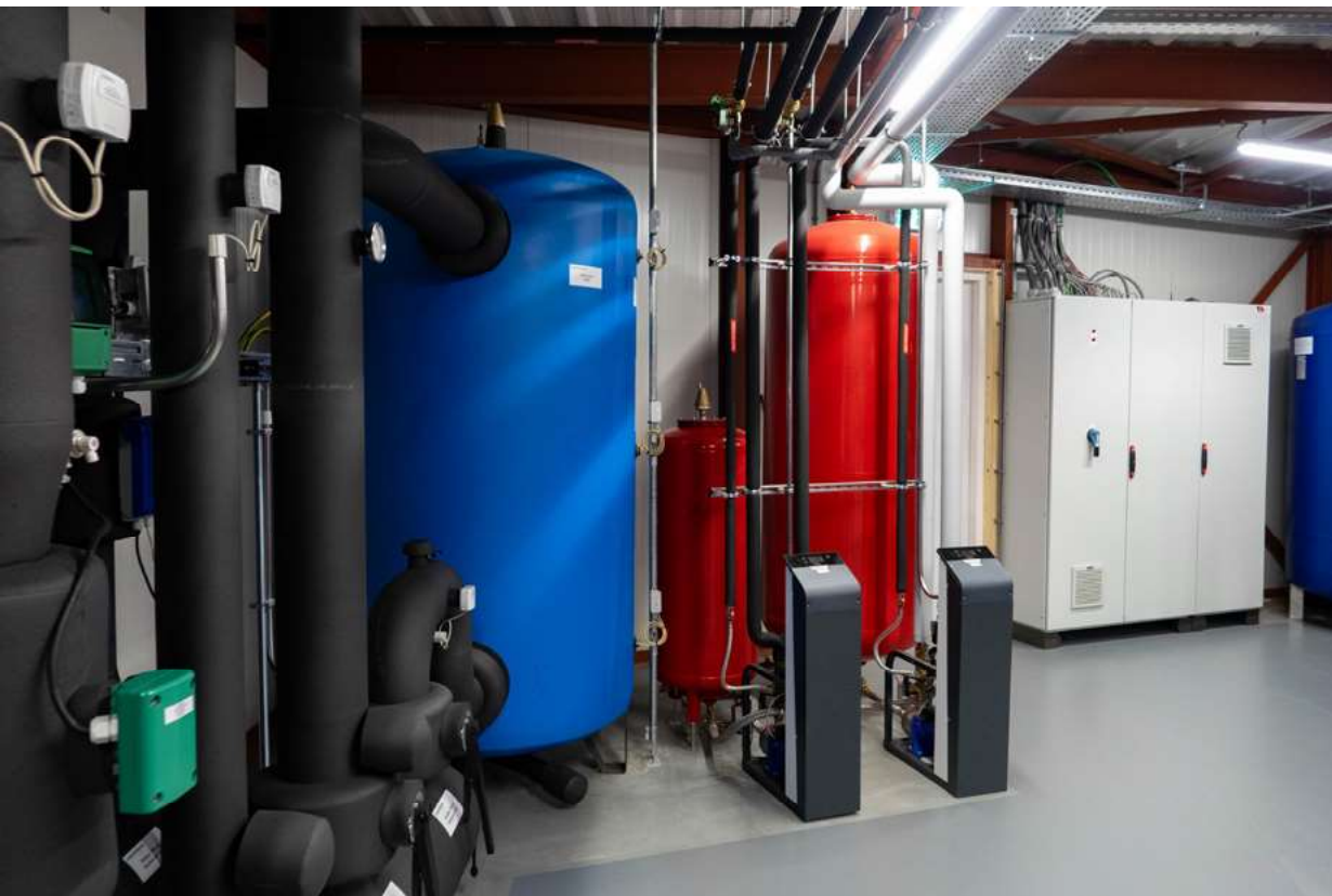
Foto 4: Het complex beschikt over vijf buffervaten van elk 5000 liter. Daarin wordt de warmte opgevangen, die wordt geproduceerd door de ijsmachine.
