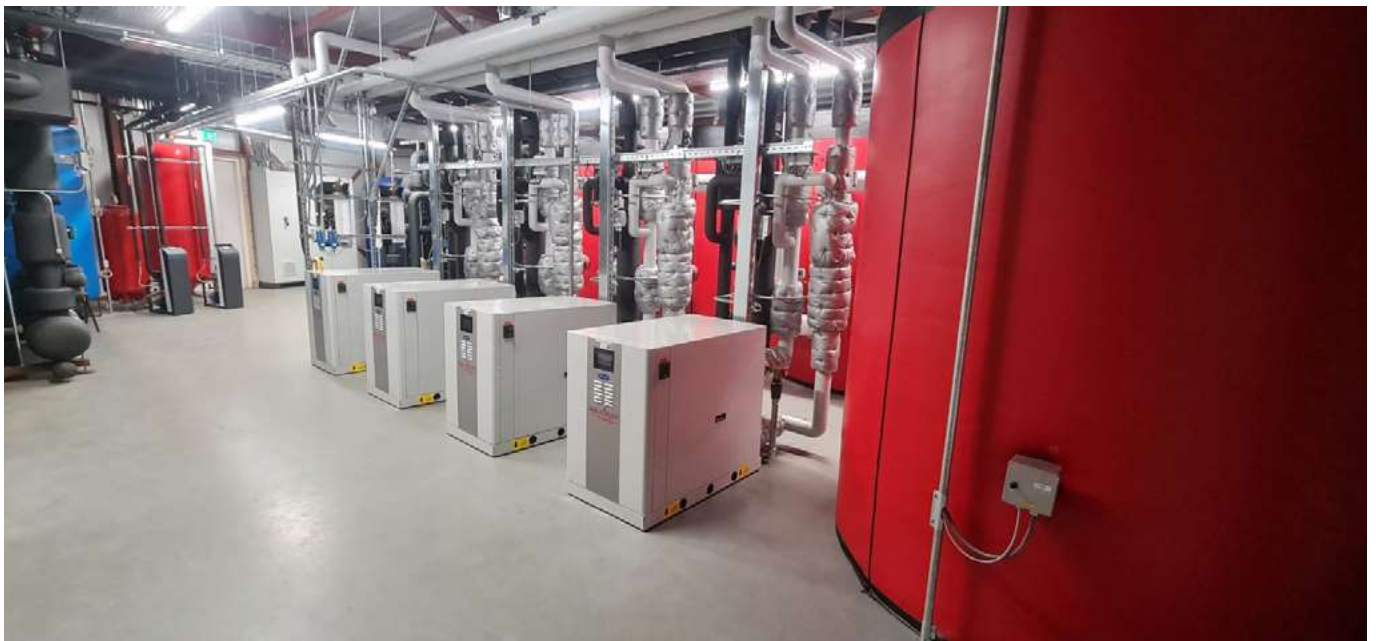
Foto 2: In de centrale technische ruimte staan 4 TSA-warmtepompen, die zorgen voor de warmte-opwekking vanuit de buffervaten en de wko, met daarnaast de grote buffervaten.
