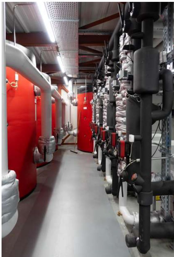
Foto 3: Buffervaten van 5000 liter, die worden gebruikt voor opslag van restwarmte uit de ijsmachine.
