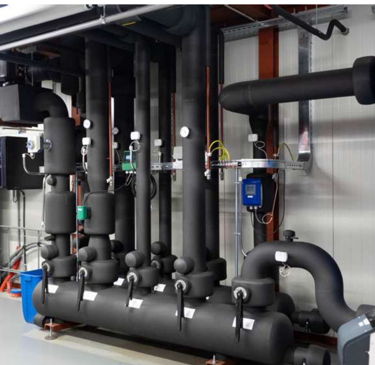
Foto 5: Verdelers waarop onder meer de warmtepompen, de primaire bron en het schakelvat voor het koudwatercircuit op aangesloten zijn.
