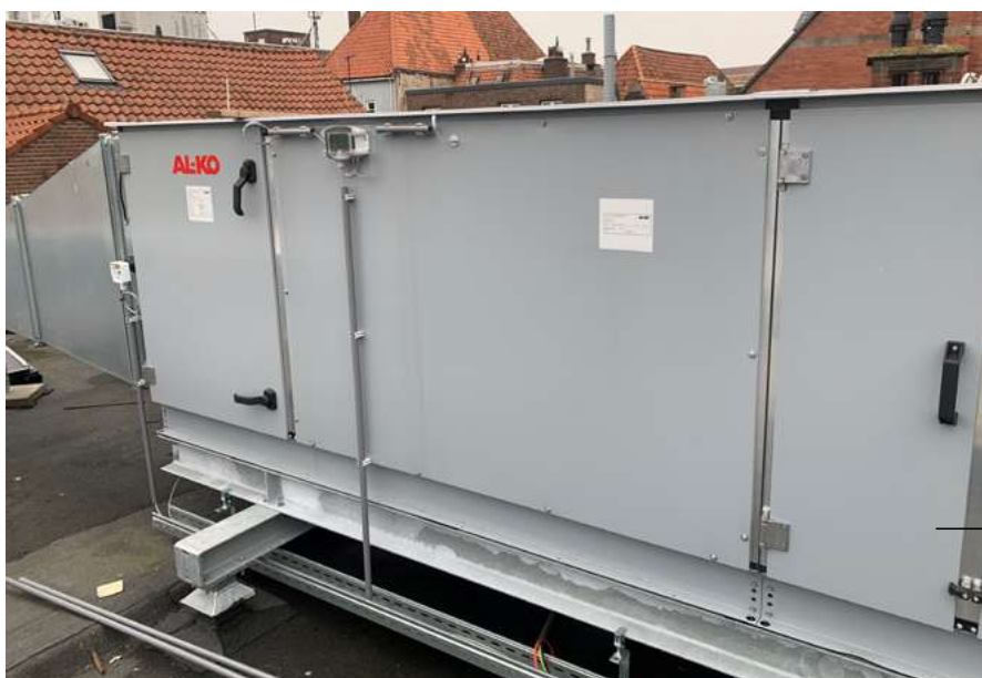
Foto 8: Op het dak van de hostel is een van de in totaal 3 luchtbehandelingskasten geplaatst, elk met een debiet van 3350 m 3 /h.
