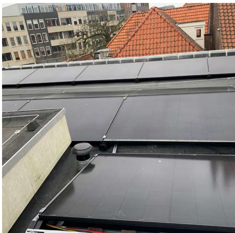
Foto 5: Ook de zonnepanelen zijn relatief vlak geplaatst. In totaal zijn op drie dakkdelen van het Statenzaalgebouw 55 pv-panelen geïnstalleerd.
