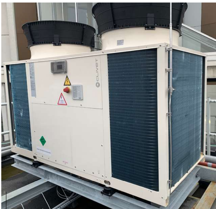
Foto 4: Op het dak is de 57 kW-warmtepomp geplaatst. Die is zo ver mogelijk naar achteren op het dak gezet, zodat vanaf de straat deze en de luchtbehandelingskasten niet te zien zijn.
