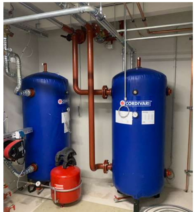
Foto 3: In de technische ruimte van de hostel zijn de buffervaten van de warmtepomp opgesteld.
