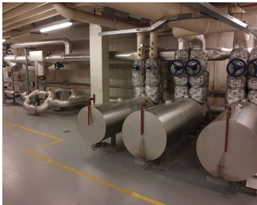
Foto 1: De technische ruimte van het stadhuis van de gemeente Den Haag. Rechts op de foto staan 3 warmtewisselaars (2 TSA's voor hoge druk installatie, en 1 TSA voor lage druk installatie).
