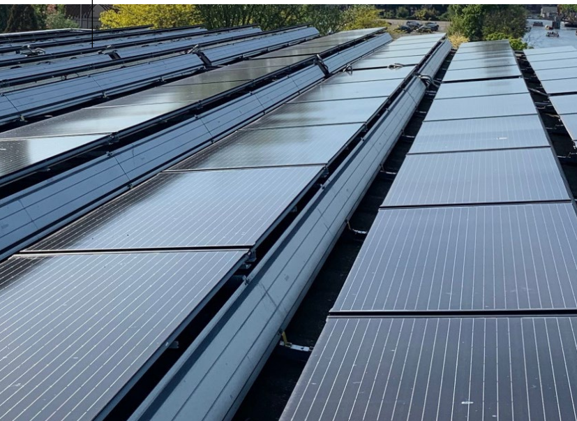
Figuur 1: Triple Solar PVT-panelen.
