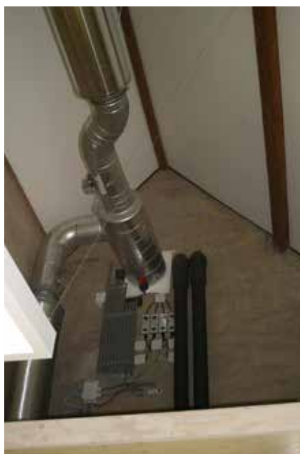
Foto 6: De installatietechniek is bewust in het zicht gelaten, maar wel op logische plekken.
