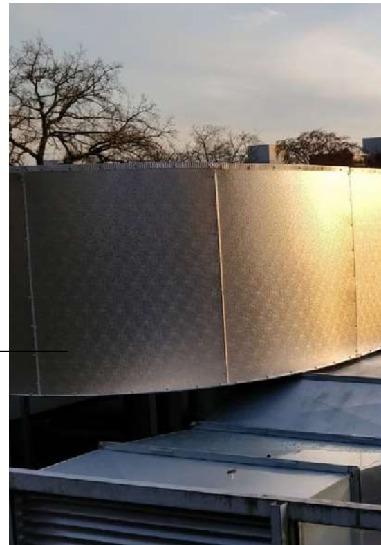
Foto 3: SchoolVent luchtbehandelingskast met geïsoleerde luchtkanalen.
