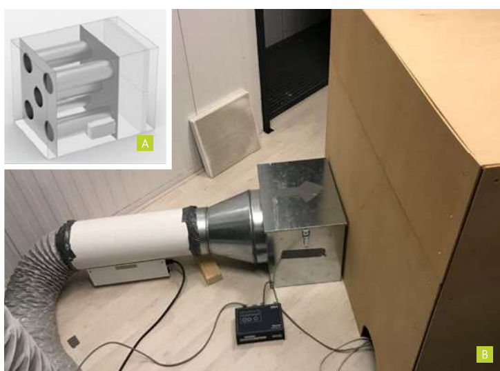
Foto 2a: Elektrostatische filtratie module voor een 10.000 m 3 /h luchtbehandelingskast. In de buizen worden de deeltjes elektrisch opgeladen. Vervolgens wordt dit fijnstof afgevangen door het F7 plaatfilter aan de rechterzijde wat als collector fungeert.
