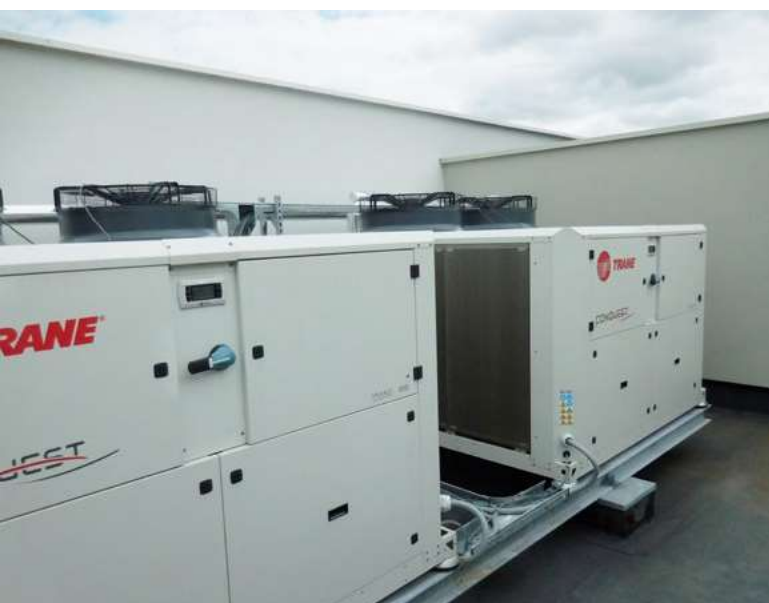
Foto 5: De warmtepompen staan uit het zicht van omwonenden.
