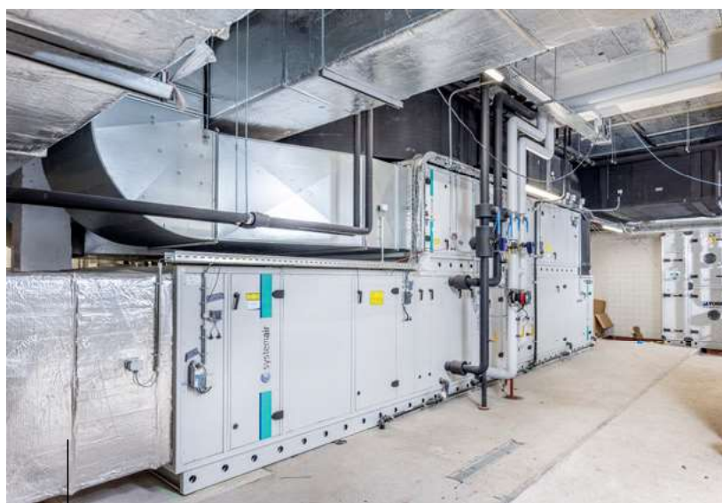
Foto 5: Daarnaast zijn in de technische ruimte drie luchtbehandelingskasten, die ventilatie en koeling leveren.
