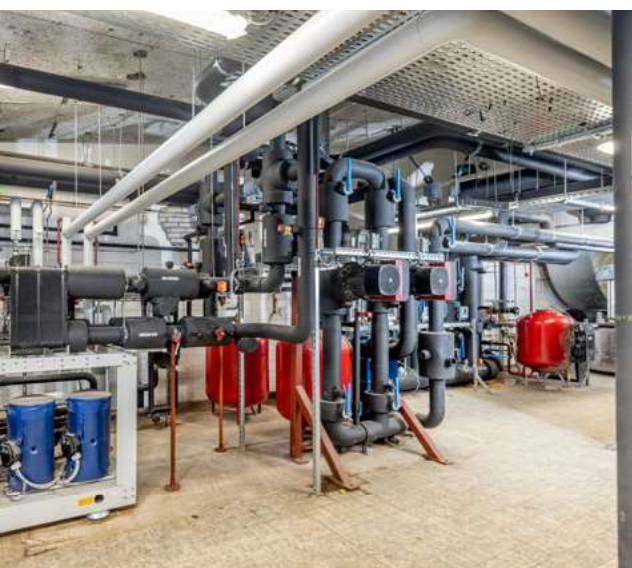
Foto 4: In de technische ruimte in het souterrain is de wko-installatie gerealiseerd. Die bestaat uit twee warmtebronnen van elk 100 m 3 /h en twee koude bronnen van elk 100m 3 /h.
