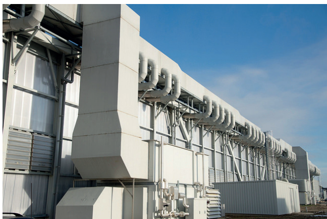
Foto 1: Voor de ventilatie van Jungola zijn vier luchtbehandelingskasten geïnstalleerd met elk een capaciteit van 60.000 m 3 /h.
