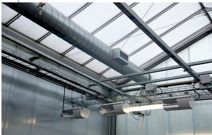
Foto 2: Aan de dakconstructie is een nevelsysteem gemonteerd dat het kan laten regenen in de kas. Ook is er een systeem om de lucht die via de gevelroosters binnenkomt direct te bevochtigen, waarmee de vereiste luchtvochtigheid gegarandeerd kan worden.
