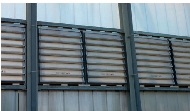
Foto 3: Langs elk van de lange gevels zijn hiervoor 60 nozzleplaten elk met 3 nozzles geïnstalleerd die de voorverwarmede lucht vanuit de luchtbehandelingskast langs het dak de kas inblazen.
