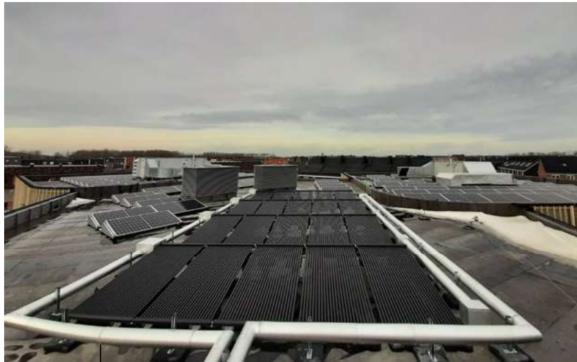
Foto 6: Op het dak liggen de pv-panelen en de vacuümcollectoren als onderdeel van het ijsbuffersysteem.
