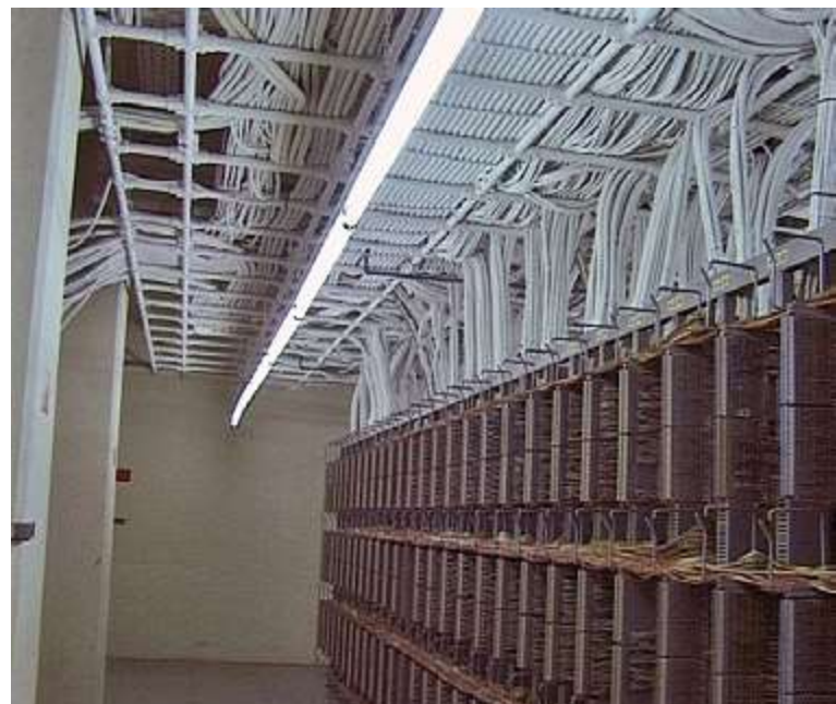
Foto 7: Datacenter bekabeling voorzien van een witte coating.
