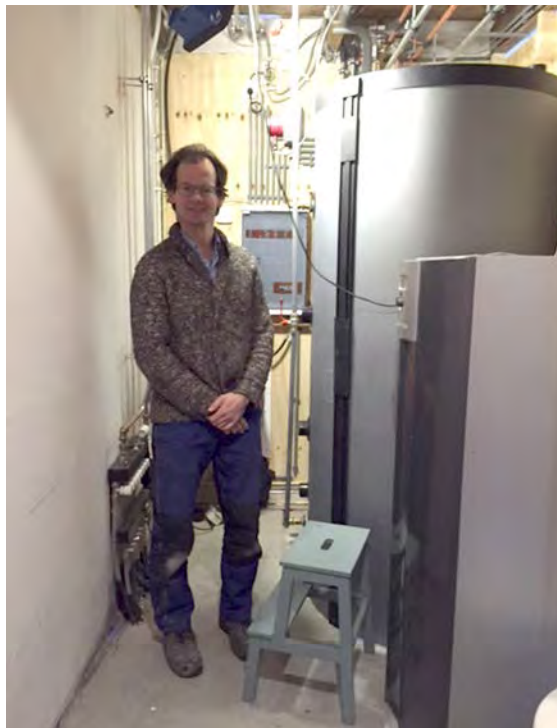
Eigenaar Niels Menken naast het 1000 liter boilervat.
