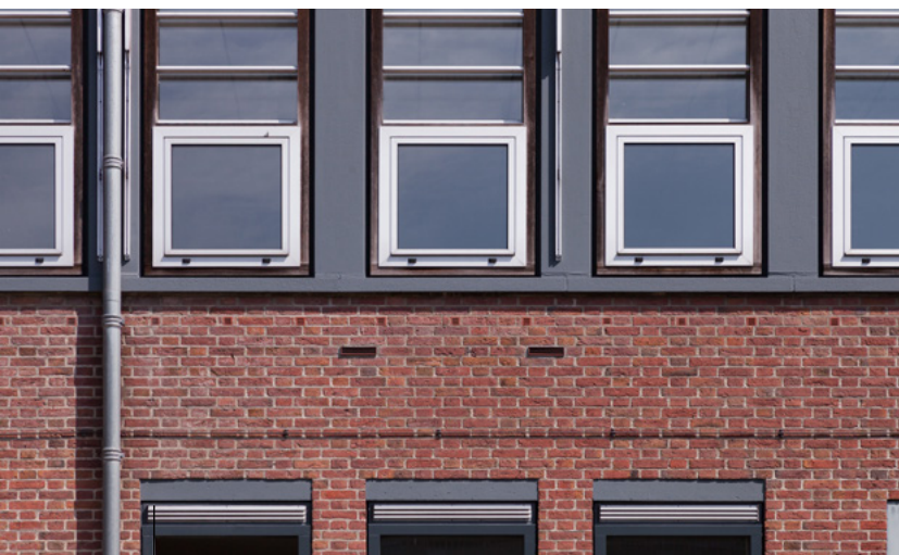
Foto 3: Voor aan- en afvoer van buitenlucht zijn in de gevel roosters gerealiseerd, die direct op de unit zijn aangesloten. De unit is voorzien van een warmtewisselaar die de inkomende 'schone lucht' voorverwarmt en daarbij gebruik maakt van de warmte uit de afgevoerde 'vuile lucht'. Het effect hiervan is hoog comfort en energiebesparing. Bron: 5d Architectuur & Fotografie.
