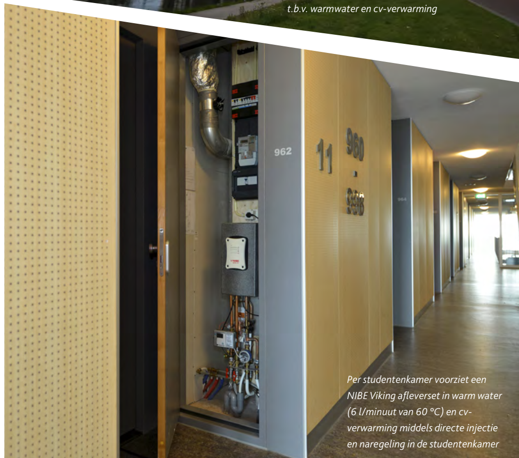
Studentenflat in Delft, voorzien van afleversets t.b.v. warmwater en cv-verwarming
