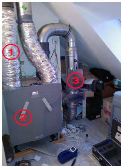
-Figuur 3- Installatie van de onderzochte luchtreiniger
