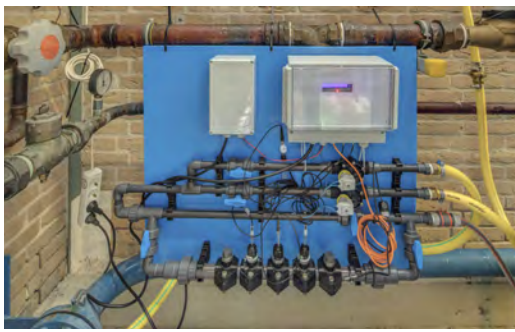
-Foto 7- Sodi Sensor in de bypass van een wateronthardingssysteem tijdens de praktijktest bij een grote Nederlandse installatie
