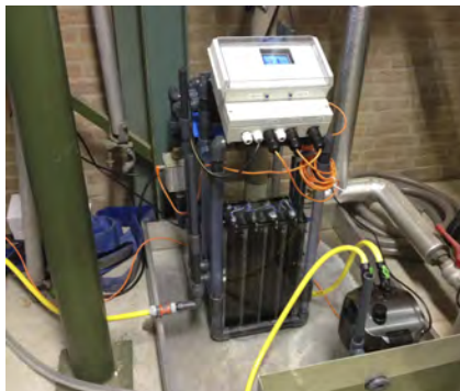
-Foto 4- Deel van de opstelling van de koper- en zilverterugwinmodule op de praktijklocatie. Rechtsonder staan de buffertank en pomp en in het midden de plexiglazen koperterugwinmodule. De koperelektroden (niet zichtbaar) zijn geplaatst tussen gecoate titaanelektroden (zwart gaas). Bovenop deze terugwinmodule staat de microprocessor gestuurde voeding en datalogger. Achter de witte box is de zilver terugwinmodule geplaatst.
