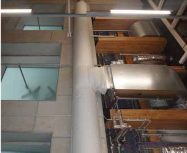
Voor het inbrengen van de lucht kent de CIRCL een circulaire oplossing: air socks. Dat zijn geheel cradle-to-cradle textiele luchtkanalen met kleine gaatjes voor ventilatie. Ze worden ook gebruikt voor luchttransport.
