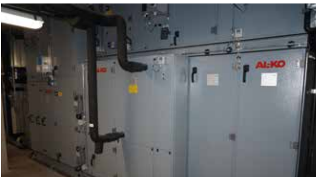
Voor de luchtbehandeling van het pand volstaat één luchtbehandelingskast van 10.000 m 3 /h, die in een van de twee technische ruimtes in de kelder staat.
