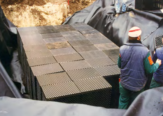
-Figuur- 3. Op het terrein van ziekenhuizen moeten maatregelen getroffen worden zodat regenwater kan infiltreren of snel kan worden afgevoerd
