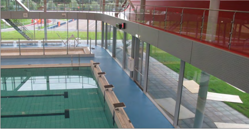
Het 25 meter bad van het Ronald McDonald Centre Only Friends heeft een zeer duurzaam ventilatiesysteem
