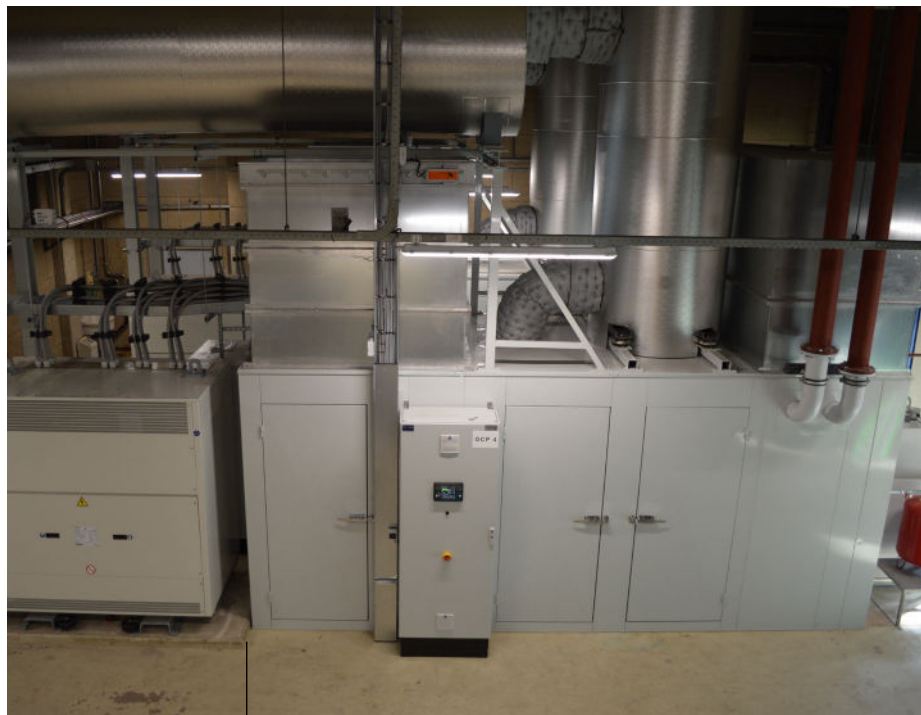
Foto 2: Eén van de twee nieuwe 1750 kW dieselaangedreven NSA's.
