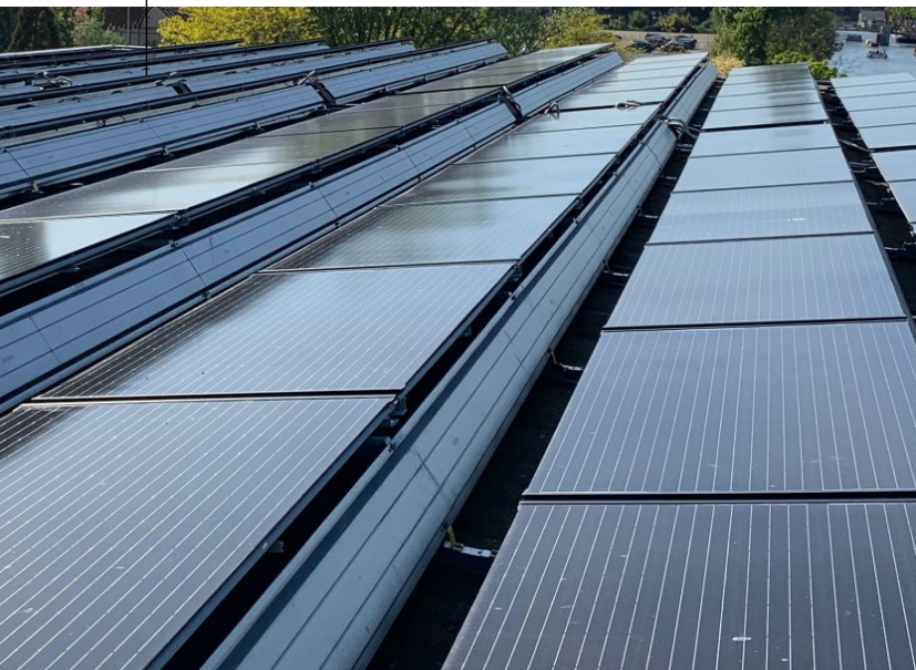
Figuur 1: Triple Solar PVT-panelen.
