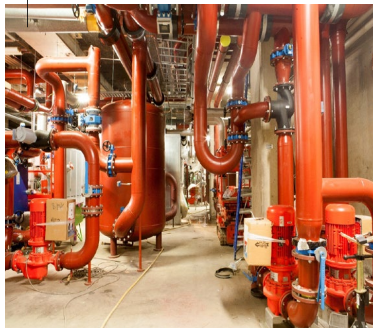
Foto 1: Installatie in de kelder van het Erasmusgebouw, voordat leidingen en buffervaten werden ingepakt in isolatiemateriaal. Foto: Jos Janssen
