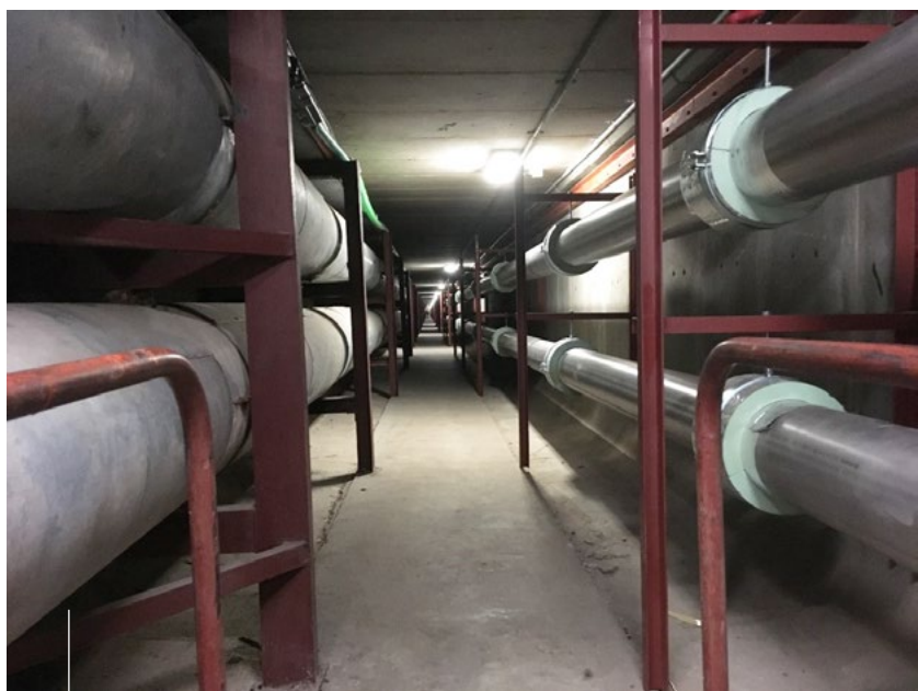
Foto 3: Links de bestaande warme leidingen, rechts de nieuwe koude leidingen in het nieuwe 'hybride' deel van het warmtenet.
