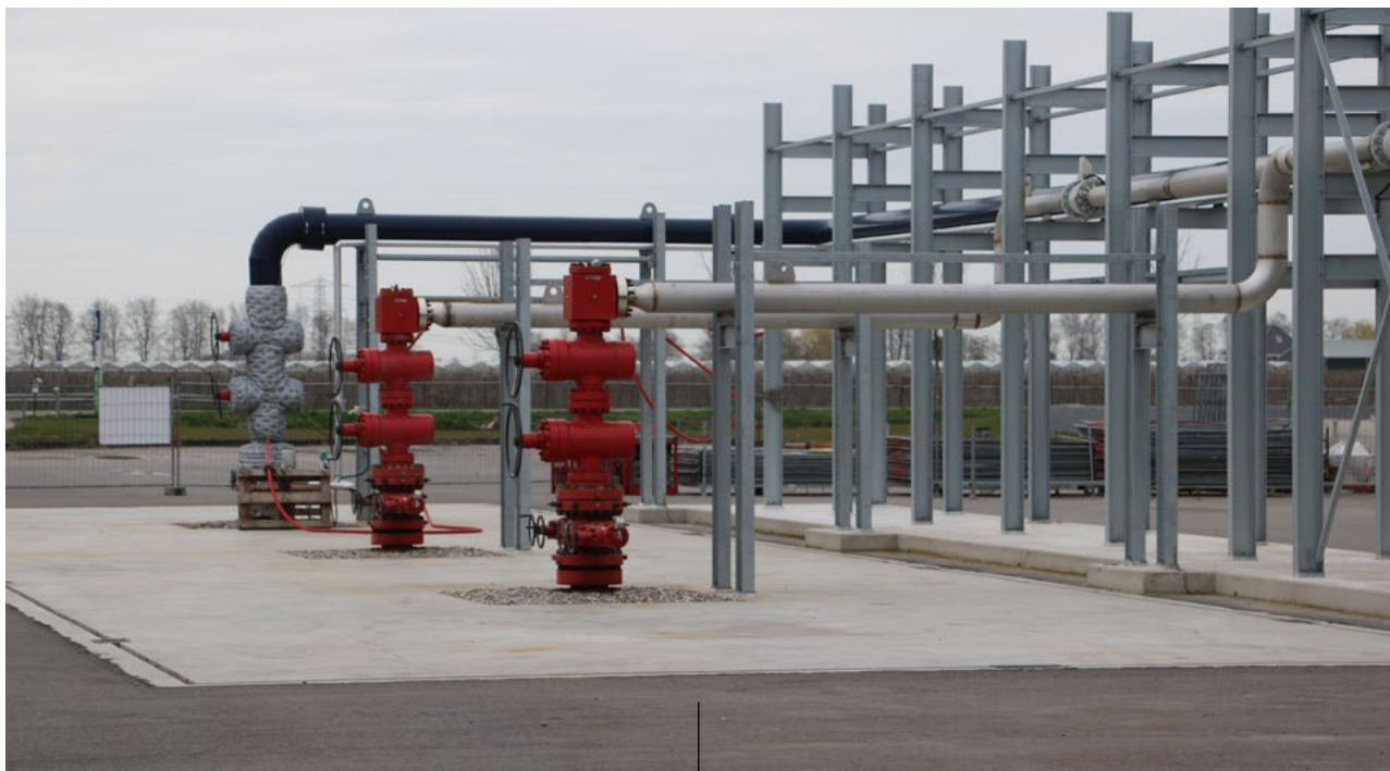
Foto 3: De well-heads Geothermie
