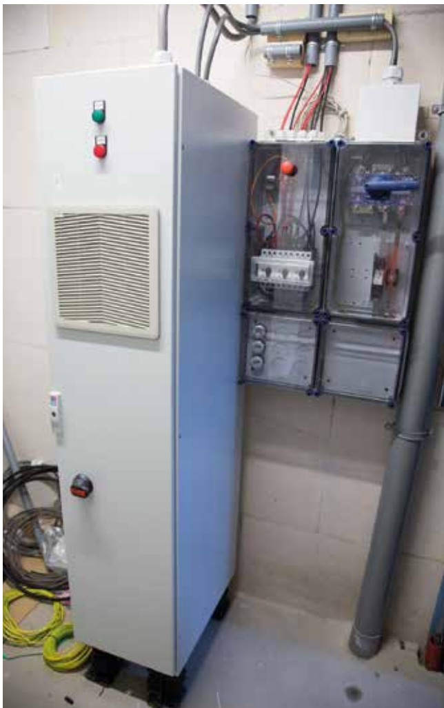
De directionele omvormer staat naast de DC-verdeler in de technische ruimte. Deze module zorgt er voor dat de appartementen zowel wisselspanning uit het elektriciteitsnet DC-voeding van de zonnepanelen aangeboden krijgen.
