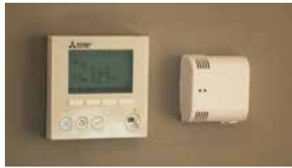
In twee van de 14 woningen zijn warmtepompen geïnstalleerd die via een app en de thermostaat aangestuurd kunnen worden. De luchtvochtigheid, temperatuur en CO2 worden met de sensor ernaast gemeten.
