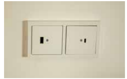
In de gelijkspanningswoningen zijn USB-C en USB2 aansluitingen geïnstalleerd, zodat dat laptops en smartphones rechtstreeks voeding 'uit de muur' kunnen halen.
