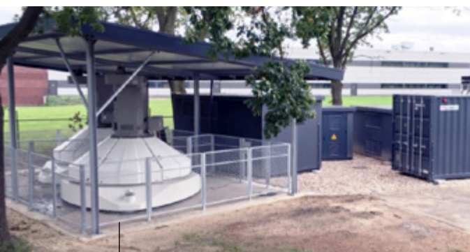
Foto 5: Vliegwielopslag van S4 Energy. Bron: S4 Energy.
