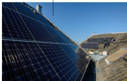
Foto 6: Zonnepanelen zijn geplaatst op de binnendaken, zodat ze niet vanaf straat zichtbaar zijn.
