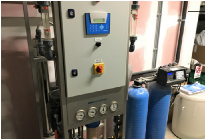
Foto 3: De installatie voor het suppletiewater voor de klimaatcascade. Die levert door middel van omgekeerde osmose gezuiverd water. Dit is nodig omdat anders het water in de klimaatcascade gaat 'indikken': er komen dan te hoge concentraties zouten en mineralen.
