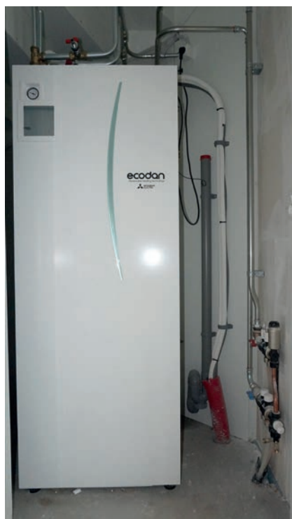
Als er voldoende energiebesparende maatregelen zijn genomen, is het overstappen op duurzame energievormen interessant, zoals warmtepompen.
