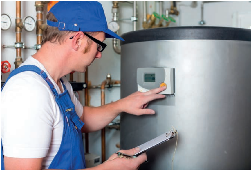
Het water dat terugkomt in de boiler moet minimaal 60 graden zijn en niet hoger dan 67 graden. Daarmee wordt het ontstaan van kalk voorkomen.
