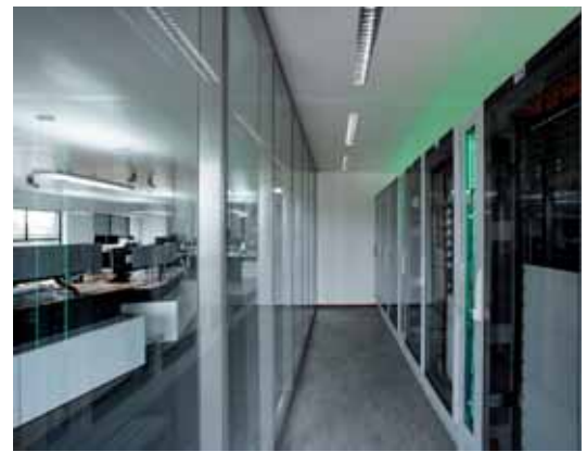
Centrale Serverruimte in Amersfoort, waarin o.a. GBS-server is opgesteld.
