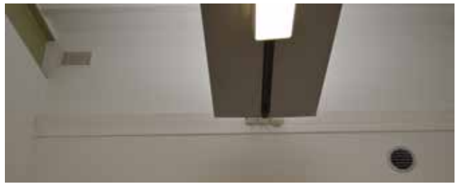
Elke kamer heeft één inblaasroostertje en één overlooprooster richting de gang. De ventilatiekanalen zijn weggewerkt achter een ongeveer twintig meter diepe voorzetwand. Foto: Tijdo van der Zee
