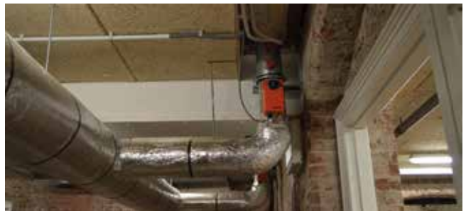
Stijgkanalen van het BaOpt/Climotion-systeem in de kelder die elk uitmonden in een uitblaasrooster in een vertrek. Elk kanaal is voorzien van kleppen (op de foto het oranje kastje van Kieback&Peter), die vanuit de kamer te bedienen zijn. Foto: Tijdo van der Zee
