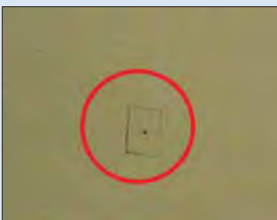
Rookdetectiesysteem (ASD) in wand.
