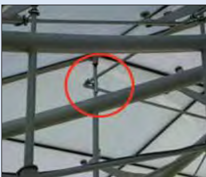
Rookdetectiesysteem (ASD) direct onder glazen dak.
