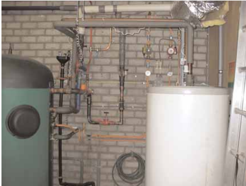
Warmtapwaterbereiding in een collectieve leidingwaterinstallatie.
