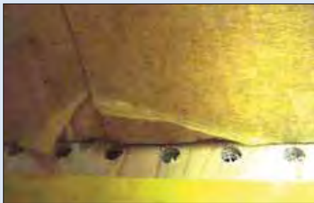
Schade aan de spouwisolatie in proefopstelling.
