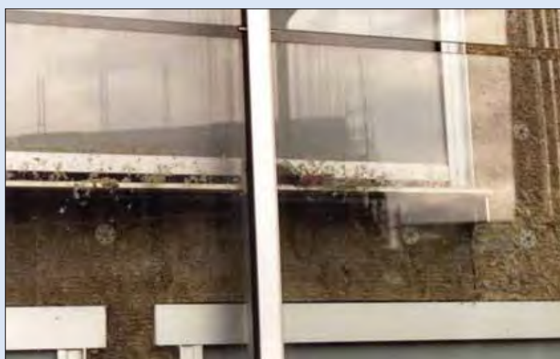
Losse steenwoldeeltjes tegen het glas van de tweede huid van het Vaktechnisch Lyceum in Utrecht.
