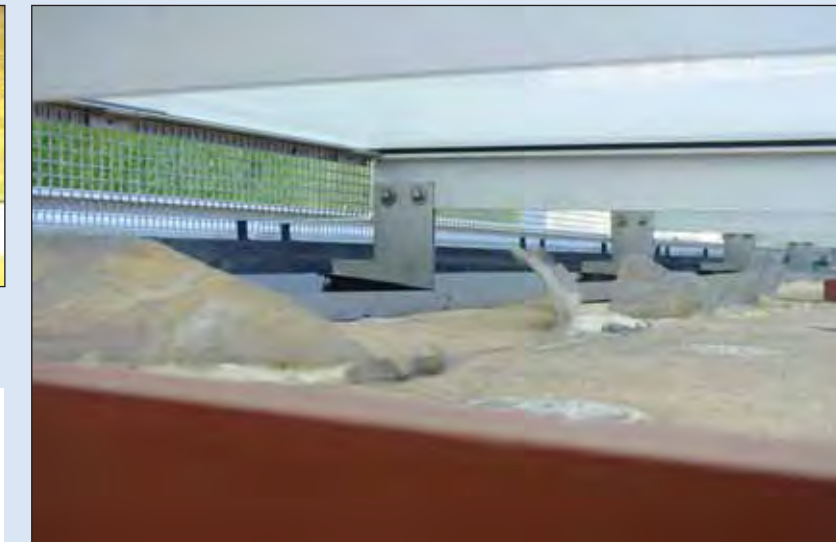
Schade aan de spouwisolatie als gevolg van hoge luchtsnelheden in de spouw.
