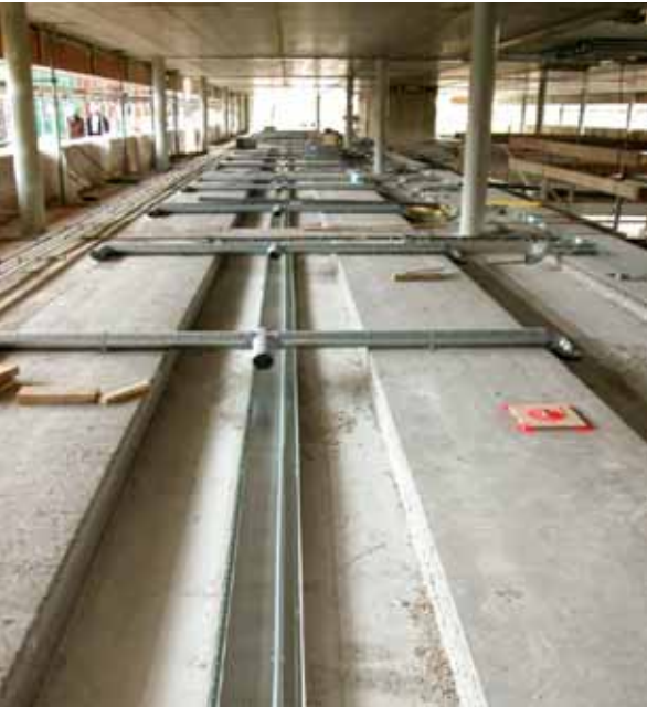
Betonkernactivering met Wing-vloeren en een verhoogde vloer. Installatieonderdelen, die onder een verhoogde vloer moeten worden gemonteerd, zijn kwetsbaar en vragen zorgvuldigheid in de uitvoering.
