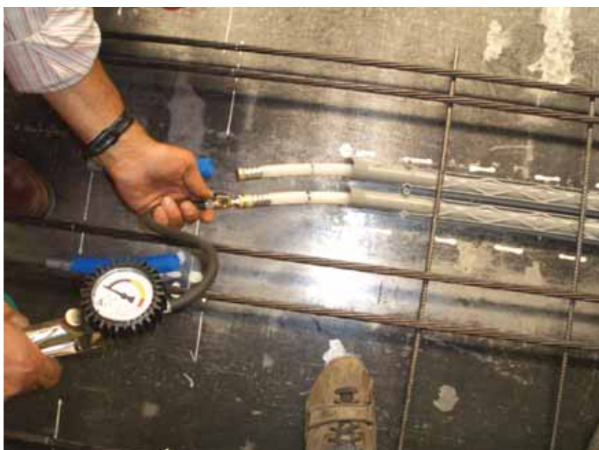
Afbakening van verantwoordelijkheden is belangrijk bij toepassing van BKA. Op de foto: meting van de druk in het slangenregister in een vloerplaat.
