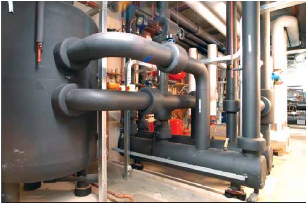
Technische ruimte met buffer, warmtepomp en installatiewerk voor de aansluiting van de Terminal op de collectieve installatie van de Oostelijke Handelskade te Amsterdam. Voor de Oostelijke Handelskade is een collectieve bronneninstallatie gerealiseerd met een centrale warmtewisselaar van waaruit gekoeld water wordt gedistribueerd. Op dit distributiesysteem zijn naast de Terminal ook andere gebruikers aangesloten (hotel, appartementen, kantoorgebouw).
